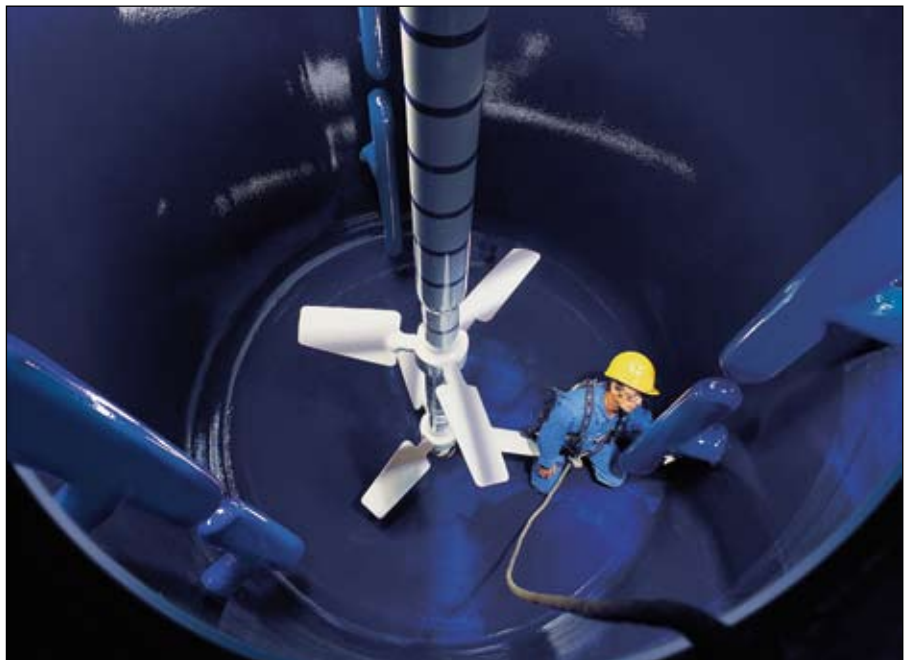
16m 3 -Rührbehälter mit an der Wand angeschweißten und komplett emaillierten Stromstörern
