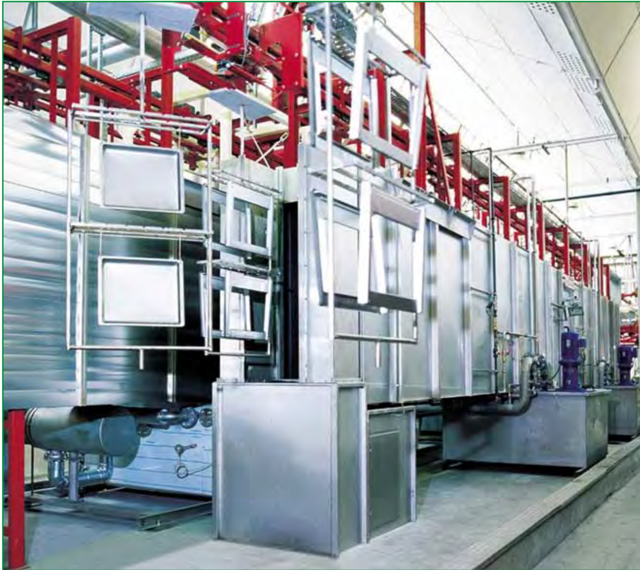
Spritzvorbehandlungsanlage (Bild: EISENMANN Anlagenbau GmbH & Co. KG)
