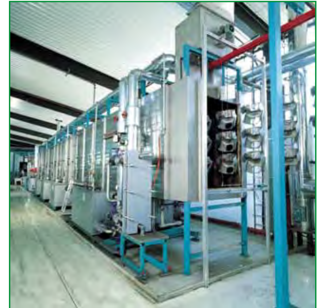
Spritzvorbehandlungsanlage (Bild: EISENMANN Anlagenbau GmbH & Co. KG)
